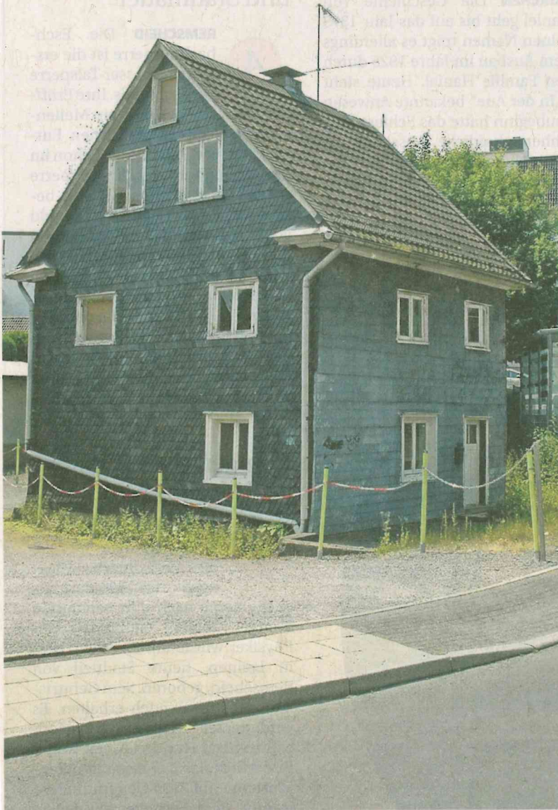
Die ehemalige Obdachlosenunterkunft an der Taubengasse: Es ist nur noch eine Frage der Zeit, bis sie zusammenbricht.
