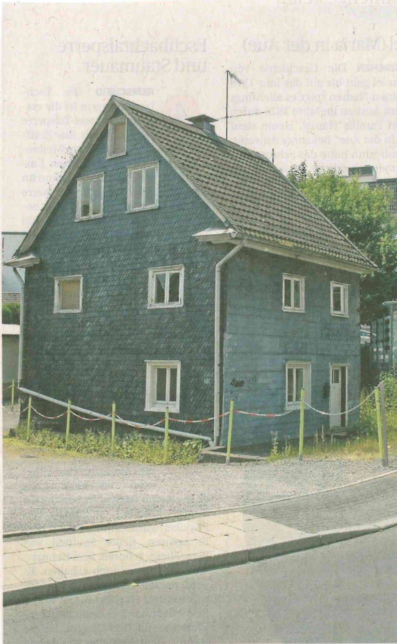
Die ehemalige Obdachlosenunterkunft an der Taubengasse: Es ist nur noch eine Frage der Zeit, bis sie zusammenbricht.
